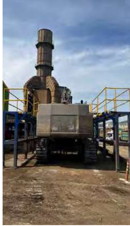
İş makinalarının güvenli bir şekilde temizlenip, yıkanabilmesi için yıkama platformu kurulmuştur.
